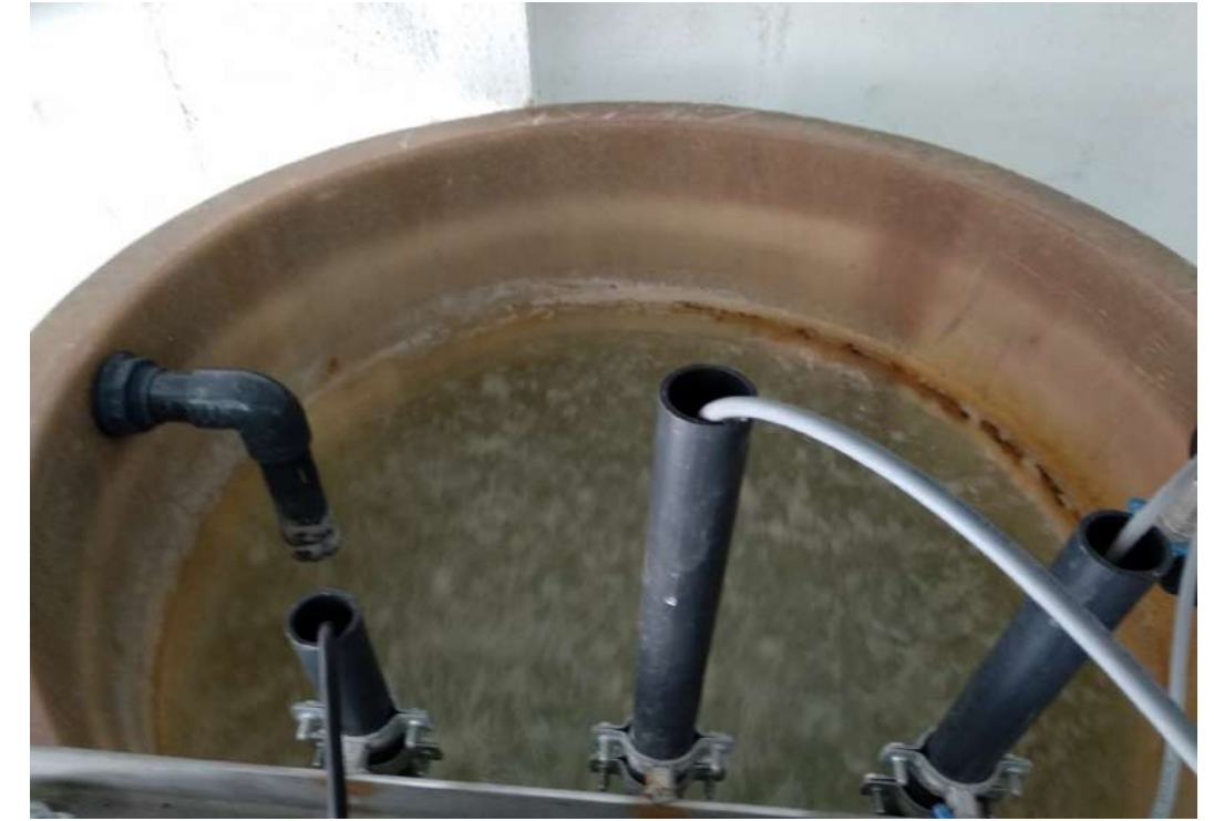
SONDAS DE CONTROL QUÍMICO
