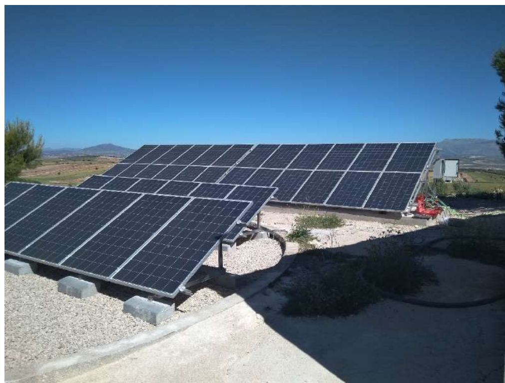
PLACAS SOLARES FOTOVOLTAICAS
