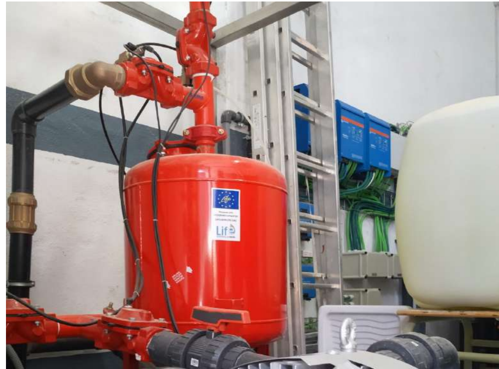
FILTRO DE ARENA
